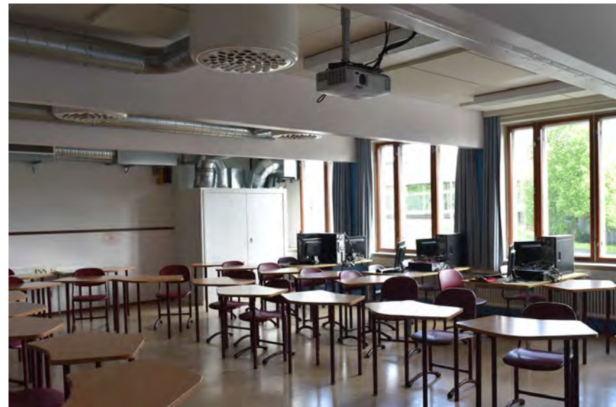
Kuva: Ilmanvaihtoputkia on näkyvissä etenkin itäsiiven luokkahuoneissa.
