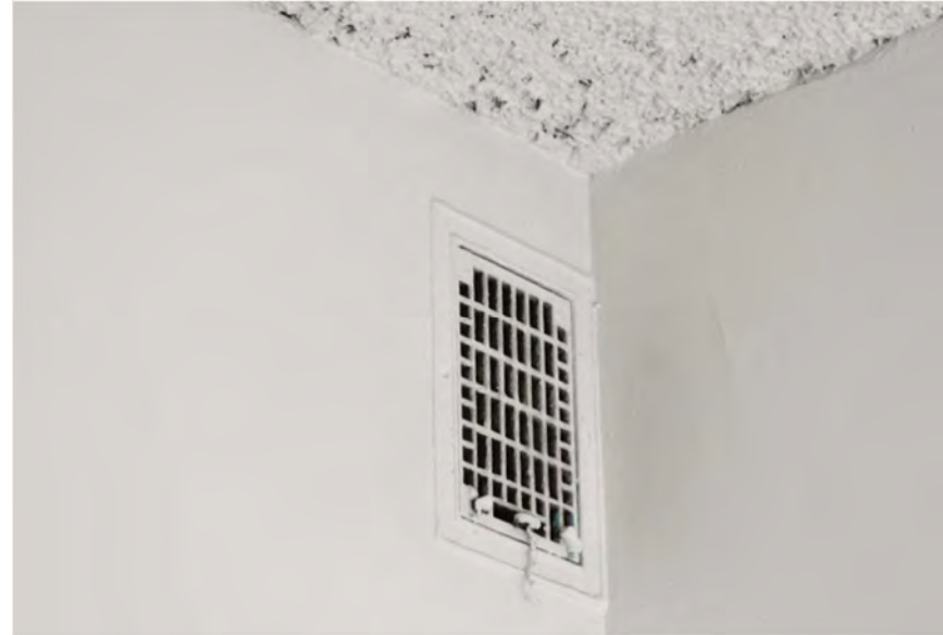
Kuva: Vanha poistoilmaventtiili länsisiiven eteläpäädyn porrashuoneessa.
