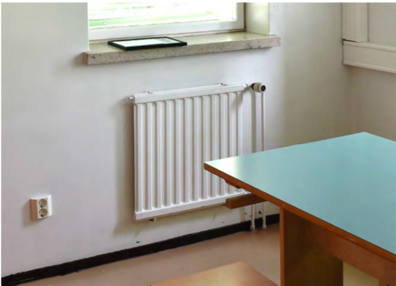
Kuva: Levyradiaattori entisessä asuinhuoneessa, länsisiiven pohjakerroksessa. Kuvassa näkyy myös mosaiikkibetoninen ikkunalauta.
