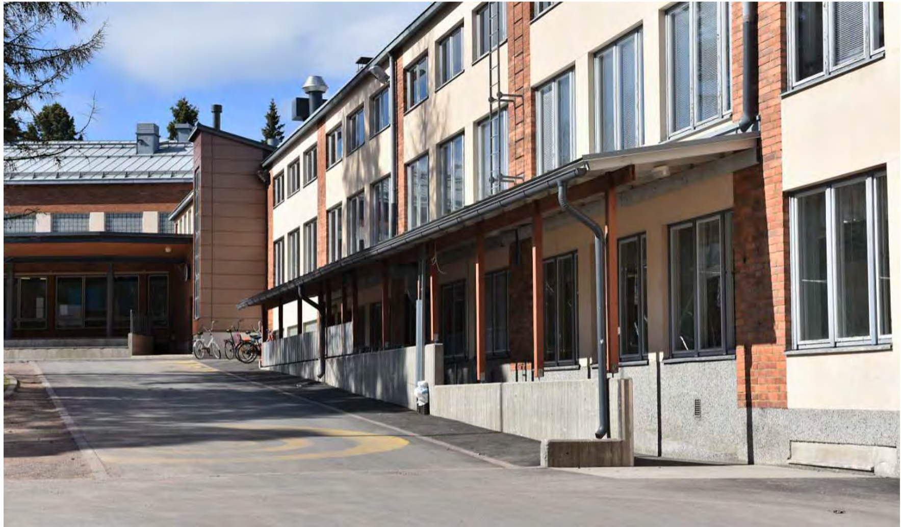
Kuva: Etualalla on itäsiiven uusi katos (1), sen takana hissikuilu (2) ja pääsisäänkäynnin sivulle tehty invaluisa (3).
