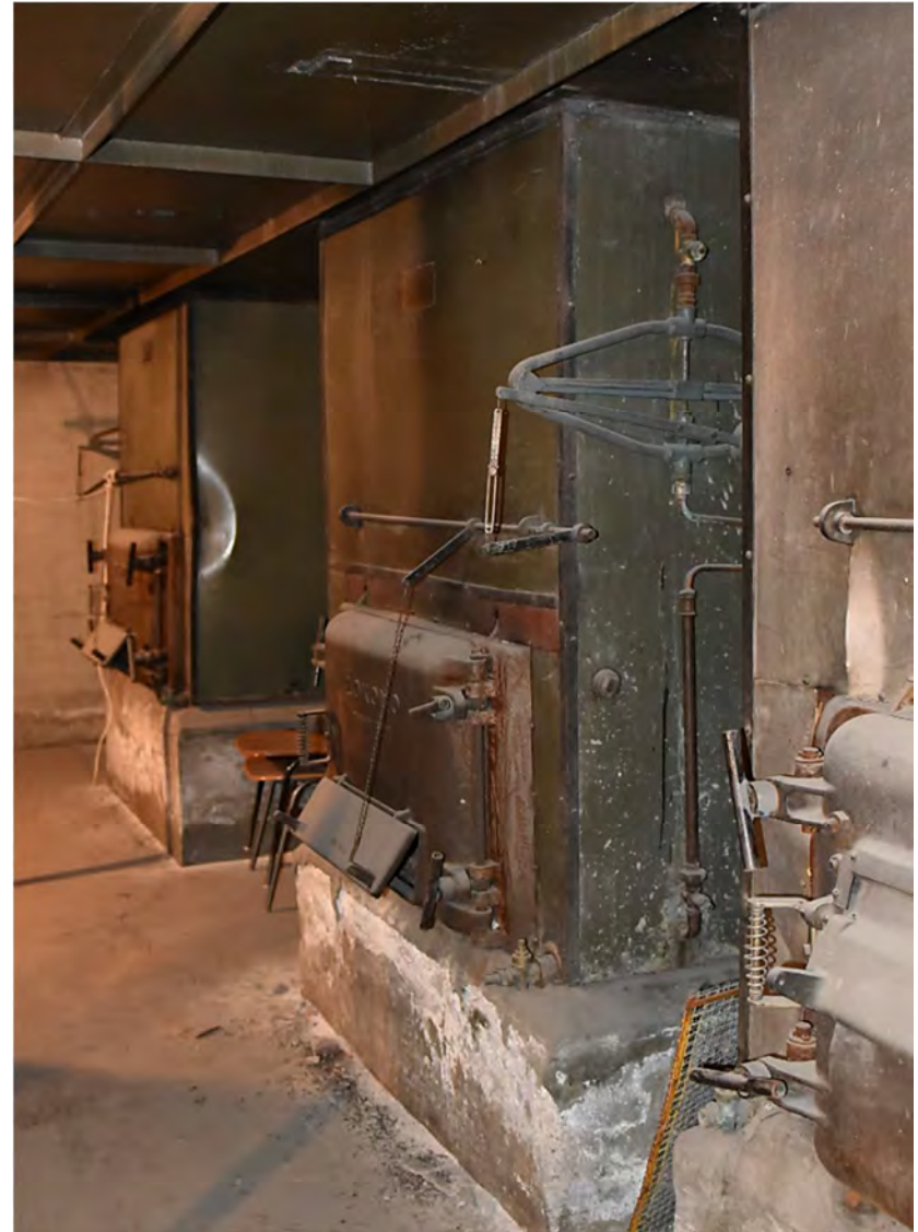
Kuva: Länsisiiven pannumontussa on jäljellä kolme alkuperäistä lämmitysuunia (LOKOMO). Lämmityshuoneen vieressä oli halkovarasto, myöhemmin siiven toiselle sivulle tuli kivihiilivarasto.
