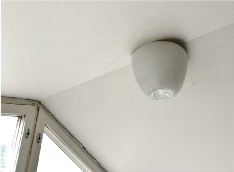
Kuva: Rakennuksessa on jäljellä yksittäisiä vanhoja opaailasivalaisimia, kuten kuvassa näkyvä kattolamppu länsisiiven eteläpäädyn porrashuoneessa. Vastaavia lampuja on kerätty talteen pohjakerroksen varastohuoneeseen.
