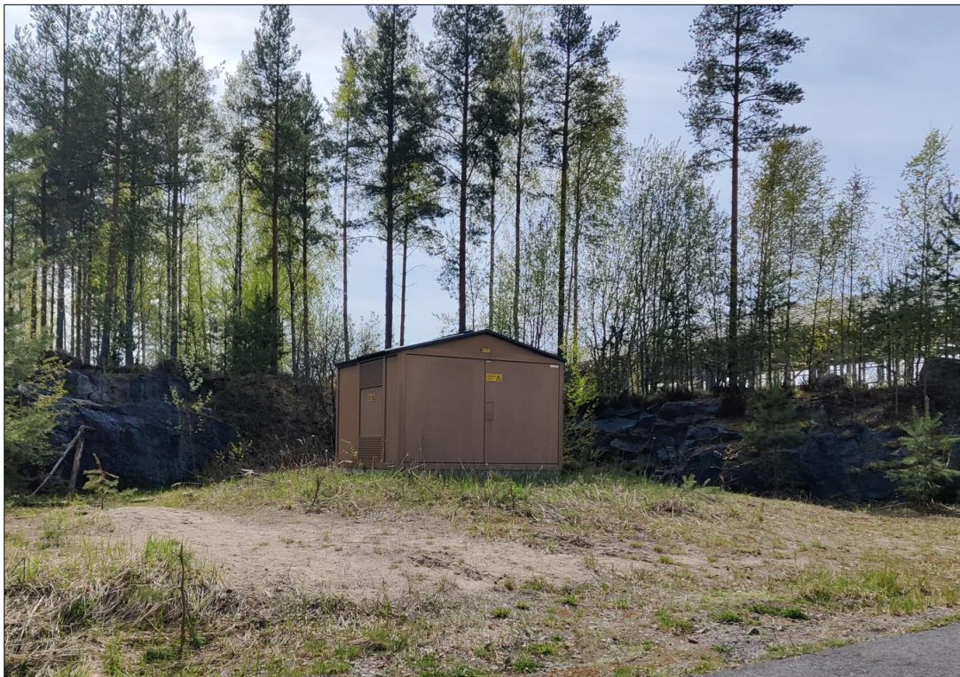
Kuva 33. Suunnittelualan keskellä sijaitseva puistomuuntamo. Taustalla näkyy osa kesken jäänyttä rakennusta.
