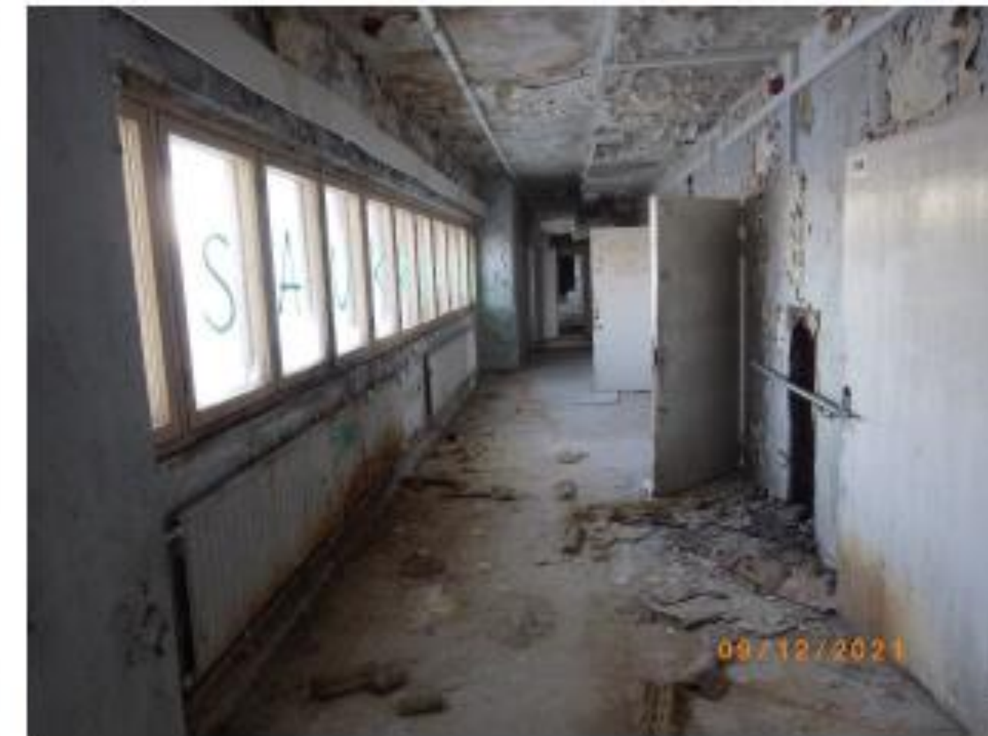
Kuva 34. Yleiskuva 7. kerroksen käytävältä. Seinissä ja muilla pinnoilla on paljon kosteuden aiheuttamia vaurioita.
