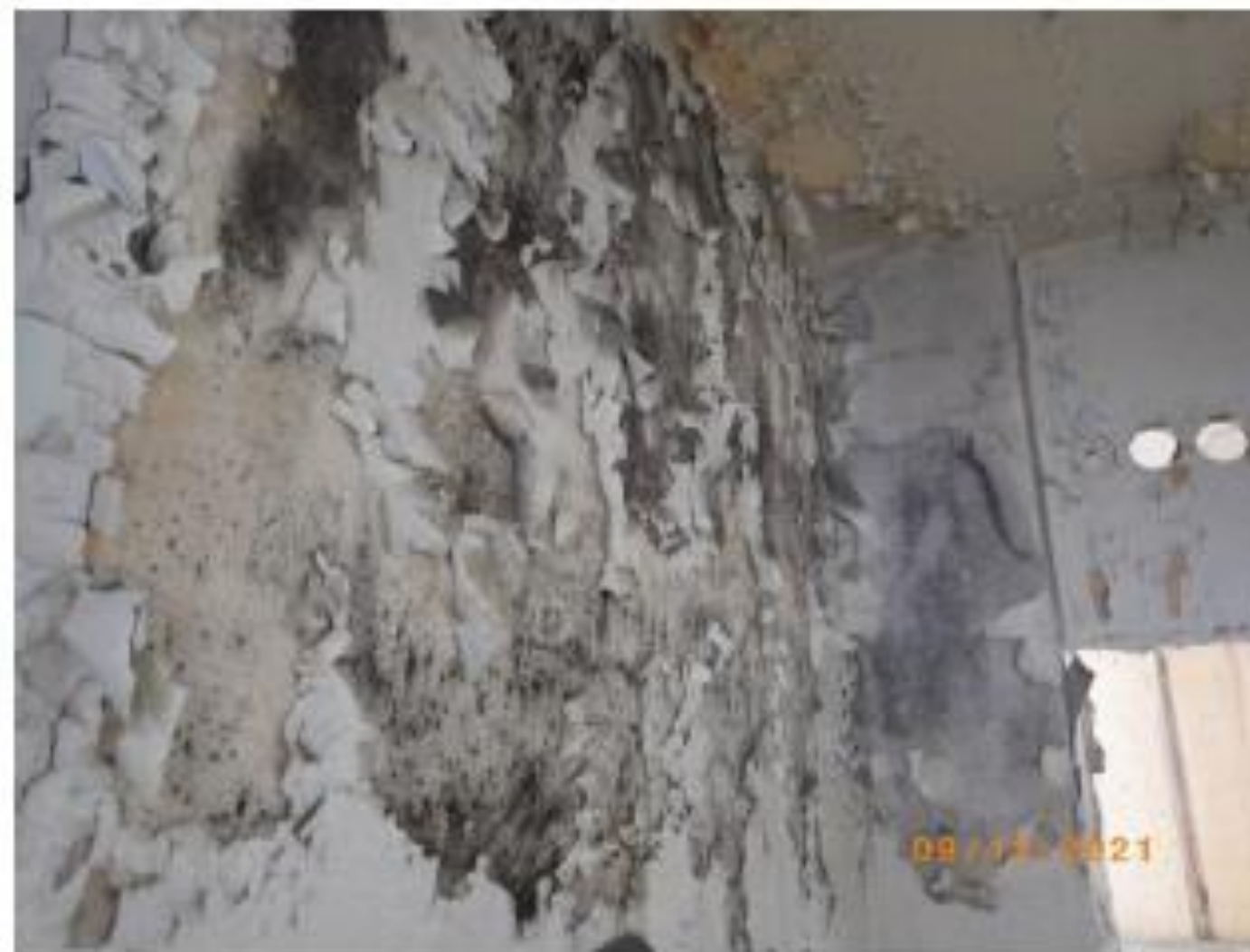
Kuva 35. Seinissä on merkittäviä kosteuden aiheuttamia vaurioita.
