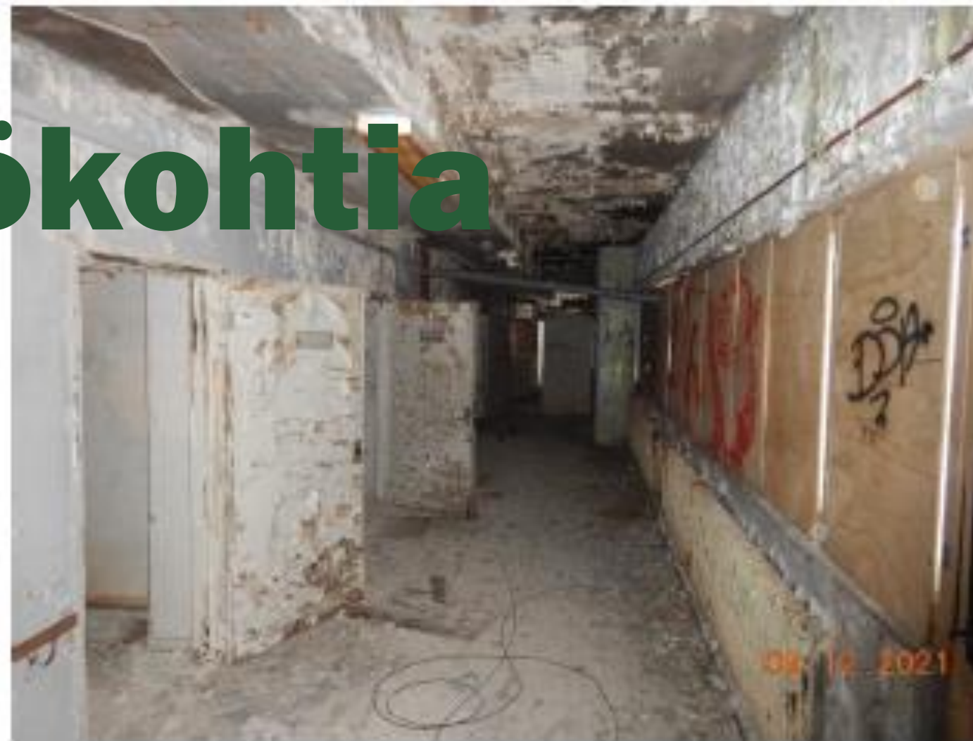
Kuva 33. Yleiskuva 8. kerroksen käytävältä. Seinissä ja muilla pinnoilla on paljon kosteuden aiheuttamia vaurioita.
