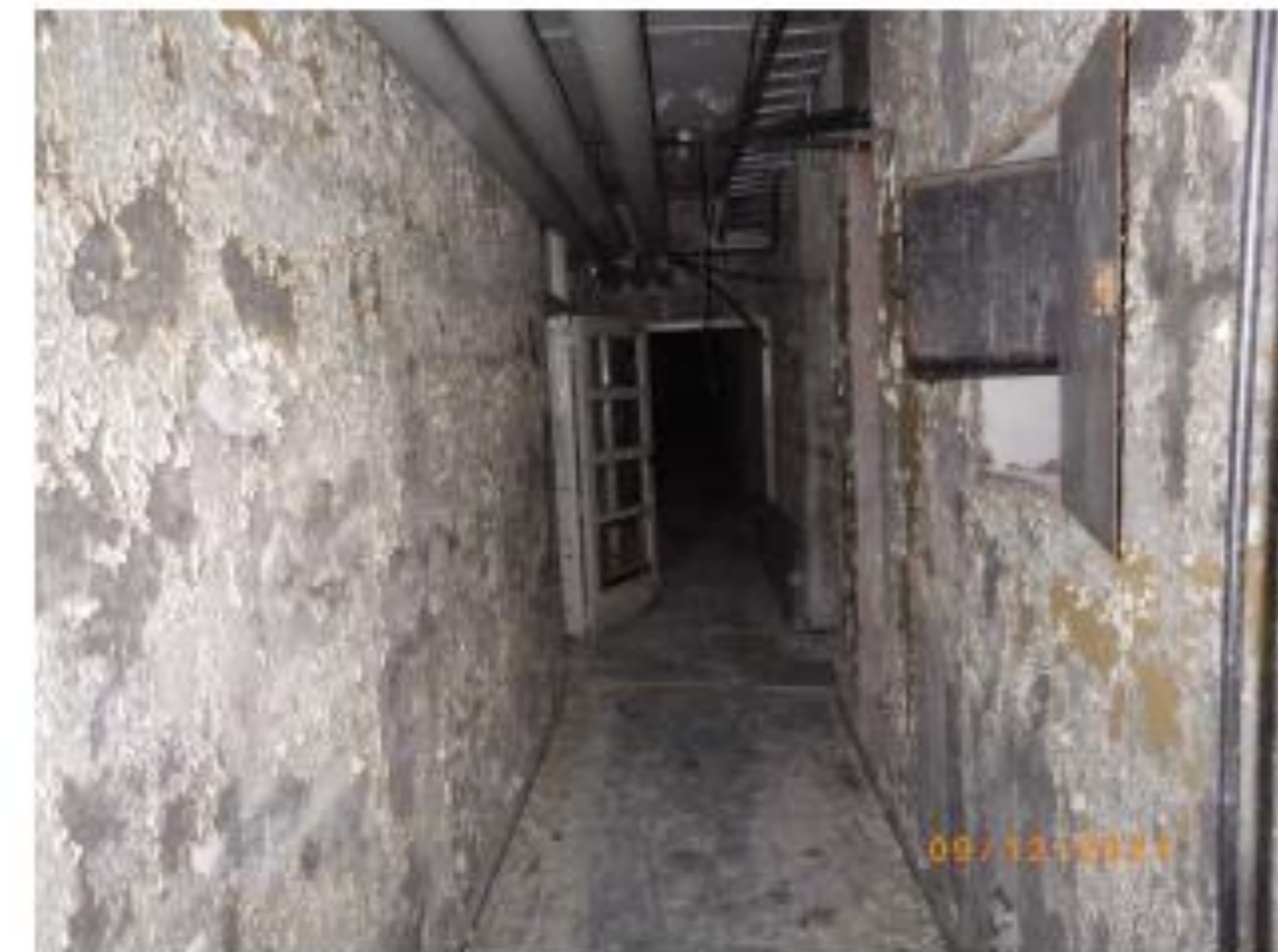
Kuva 36. Yleiskuva 01. kerroksen käytävältä. Seinissä ja muilla pinnoilla on paljon kosteuden aiheuttamia vaurioita.
