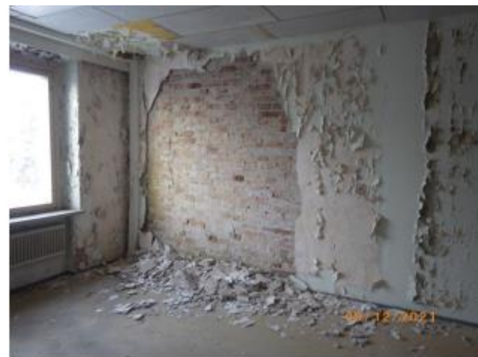
Kuva 38. Pääporraskäytävän läpikastunut seinä kuvattuna 5. kerroksesta viereisestä tilasta. Rappaus on irronnut laajana kenttänä.
